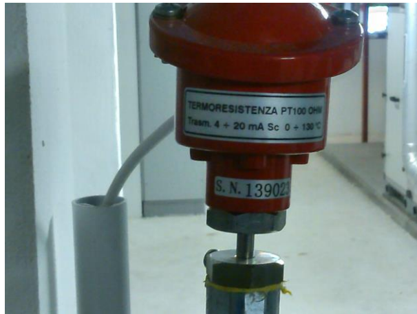
Figura 8. Immagine di una delle termoresistenze installate sull'impianto. Sono evidenti le informazioni relative alle caratteristiche dello strumento.
