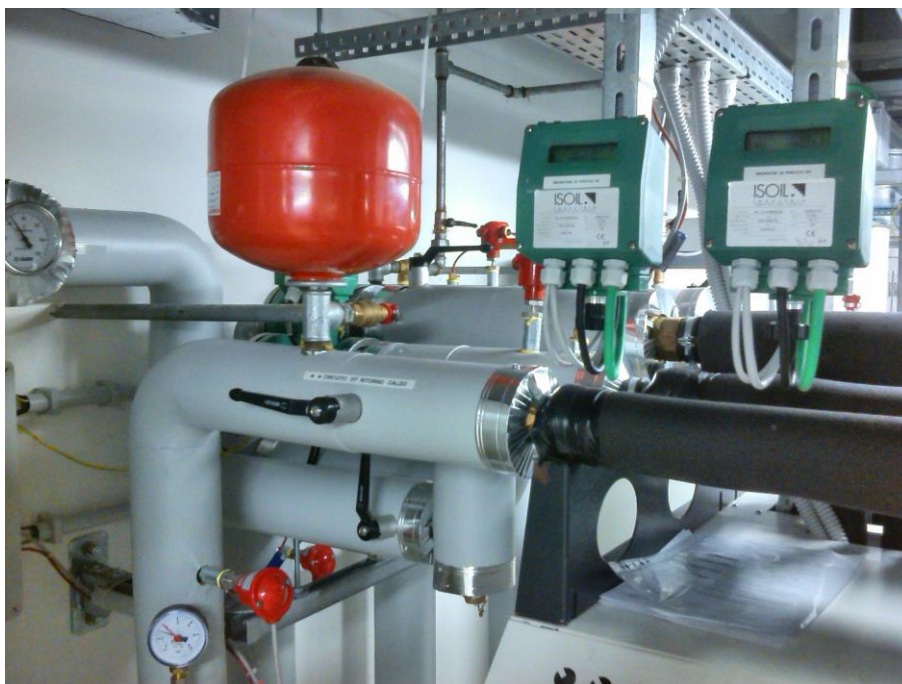
Figura 6. Fotografia dei circuiti idraulici collegati alla parte posteriore del chiller.
