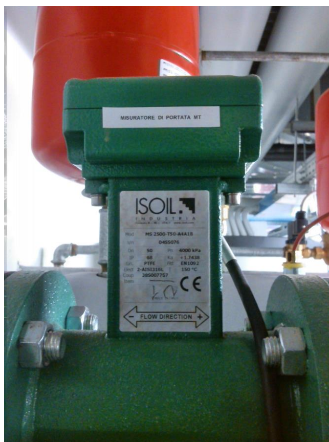
Figura 7. Immagine del misuratore di portata sul circuito MT. Sono evidenti le informazioni relative al produttore e alle caratteristiche dello strumento.
