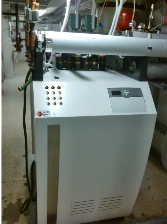
Figura 5. Fotografia del chiller installato
